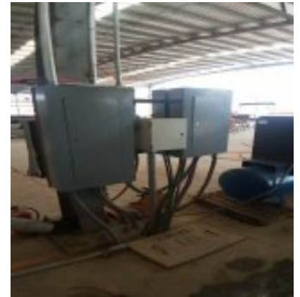
Figura 11. Caja de Carga de Energía
