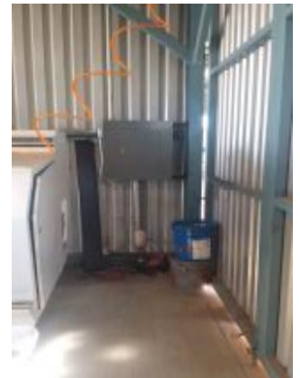
Figura 8. Caja sin Señalamientos
